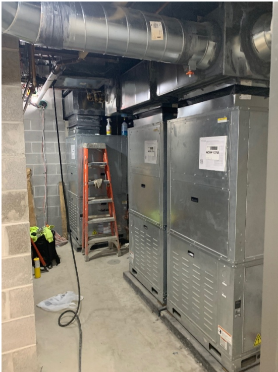
2026.05.05 – Phase 3 mechanical room
